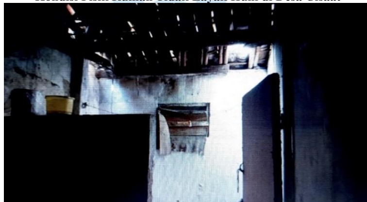
Gambar 1.3 Kondisi Fisik Rumah Tidak Layak Huni di Desa Cisaat
