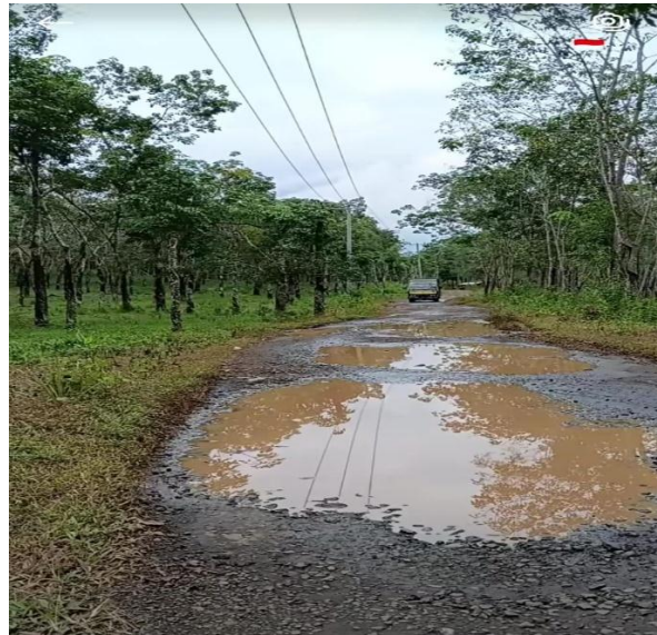
Gambar 2. Kondisi Jalan Menuju Desa Sukaluyu, Kecamatan Cikadu, Kabupaten Cianjur (04 Januari 2026)
