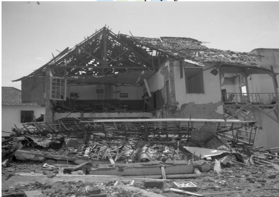
Gambar 4.1. Kantor Jawatan Telepon yang rusak 1946
