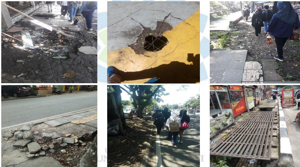
Gambar 1. 1 Kondisi Trotoar yang Rusak
